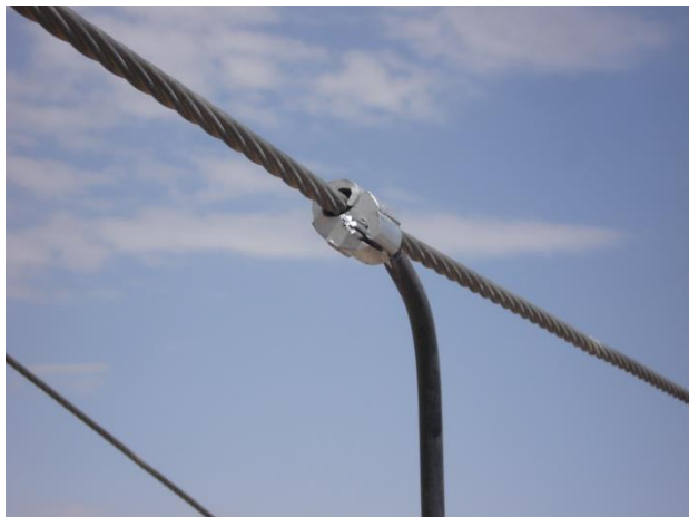
عکس ۸ - نمونه ای از بوش انشعابی S نصب شده
